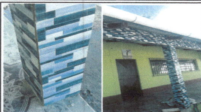
Foto 14: Repello en muro y columna de corredor de las aulas de 3ro, 4to y 6to.
